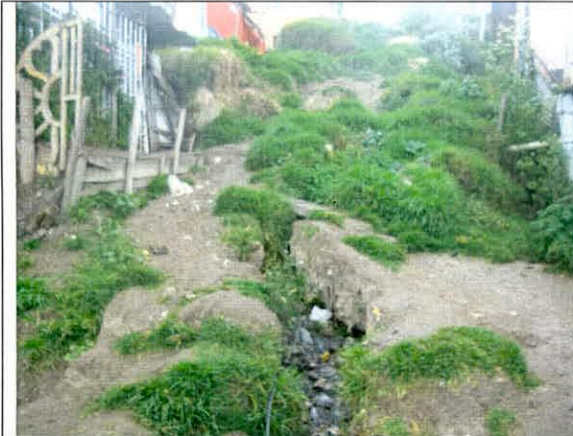
Fotografía 2. Vista de vía a la altura de la Carrera 21 y 22 en el sector evaluado entre los Barrios Los Alpes y Villas del Progreso. Se observa falta de colectores.
