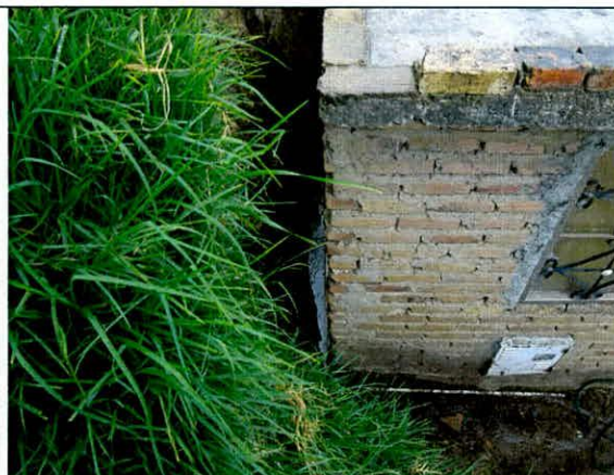
Fotografía 5. Vista en detalle de filtraciones de agua en el terreno en las viviendas ubicadas en los límites entre los barrios Los Alpes y Villas del Progreso.
