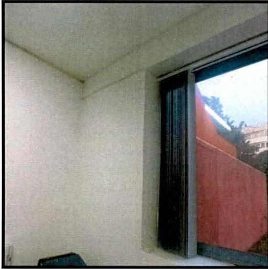
Fotografía 11. Fisuras casi imperceptibles durante la visita de Abril de 2016 al interior de la oficina del segundo nivel del Local Comercial 70
