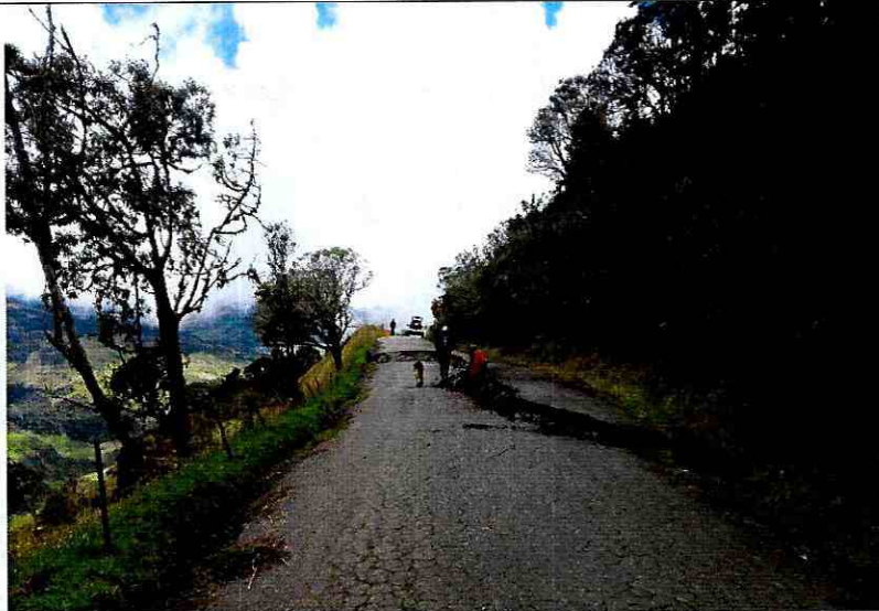
Fotografía 1: Vista del proceso de remoción en masa identificado sobre la vía que conduce al corregimiento la Unión desde el corregimiento de San Juan.
