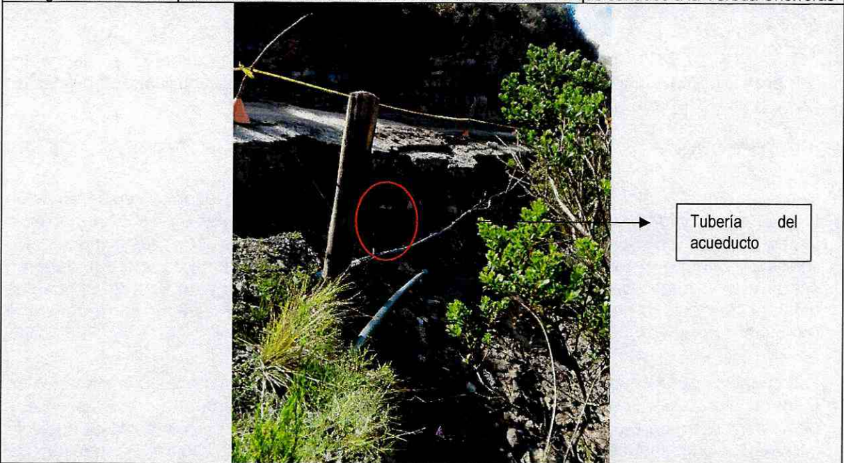
Fotografía 6: Vista del proceso de remoción en masa identificado sobre la vía que conduce a la Vereda Chorreras
