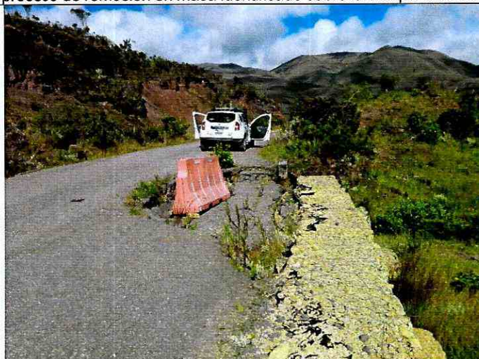
Fotografía 4: Vista del proceso de remoción en masa identificado sobre la vía que conduce a la Vereda Chorreras.
