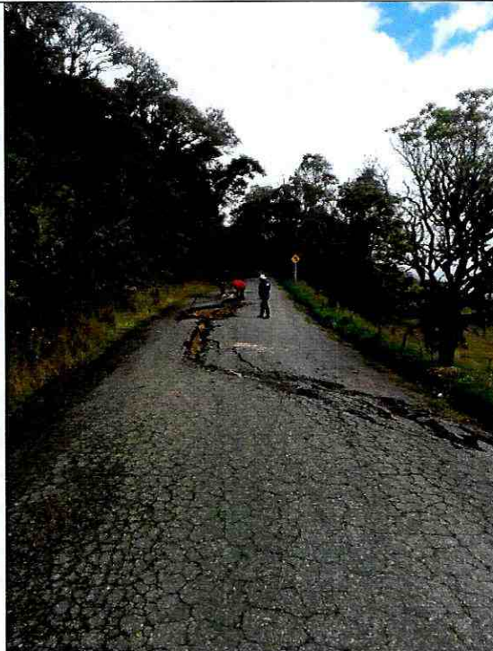
Fotografía 2: Vista del proceso de remoción en masa identificado sobre la vía que conduce al corregimiento la Unión desde el corregimiento de San Juan.
