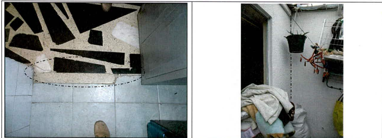
Fotos 5 y 6. Vista de las fisuras identificadas en los acabados de los pisos y en las juntas de unión de los muros de la zona de patio.
