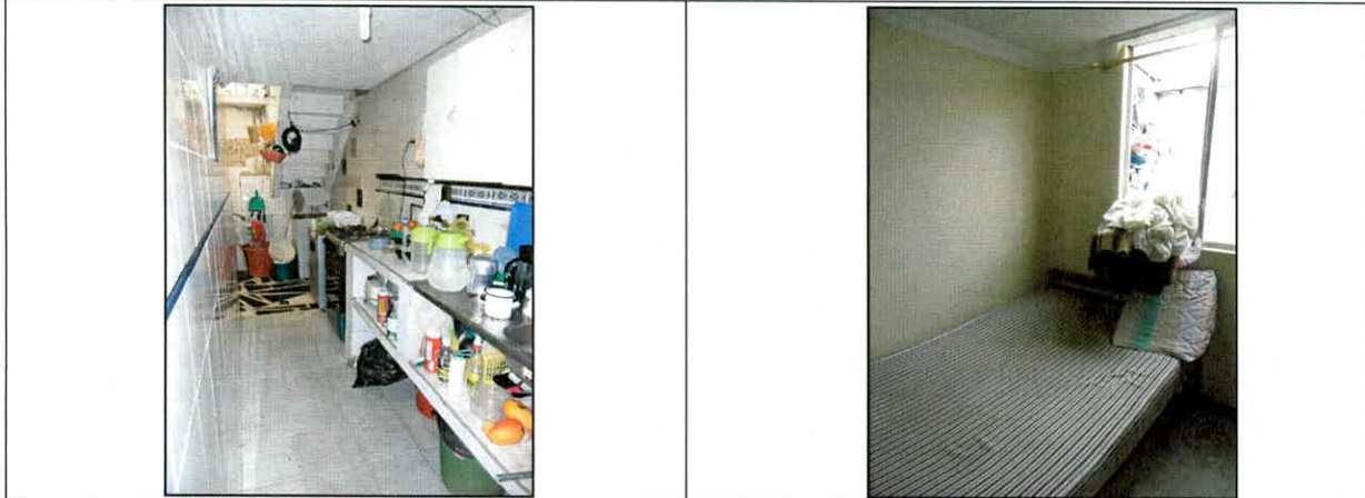
Fotos 3 y 4. Vista al interior de la vivienda en la que nos e aprecian daños que comprometan la estabilidad y habitabilidad del Apartamento 401.
