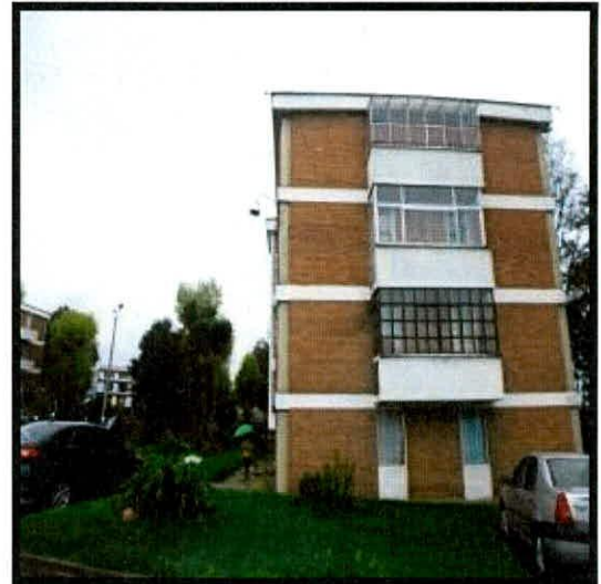
Fotografía 4. Inclinación de la Torre 2 evidenciada el 22 de Mayo de 2017
