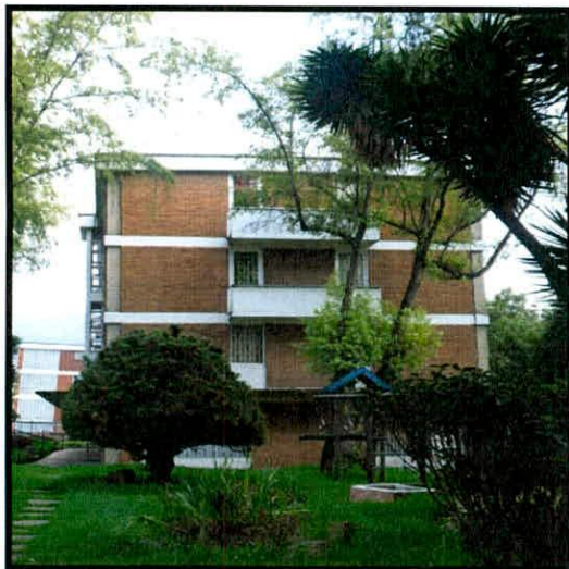
Fotografía 1. Inclinación de la Torre 1 evidenciada el 6 de Abril de 2016 DF-10415
