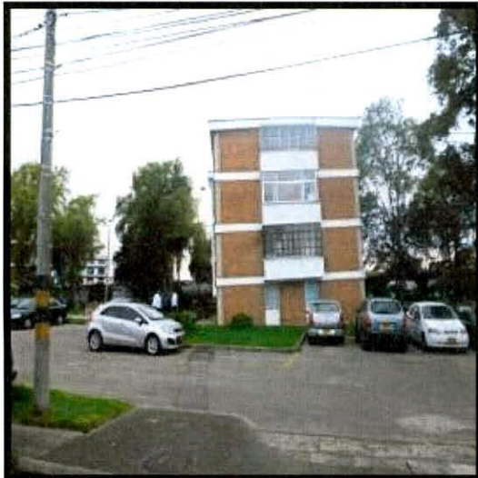
Fotografía 3. Inclinación de la Torre 2 evidenciada el 6 de Abril de 2016
