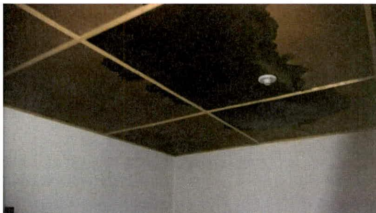
Fotografía 2. Presencia de humedad en el cielo raso de la edificación
