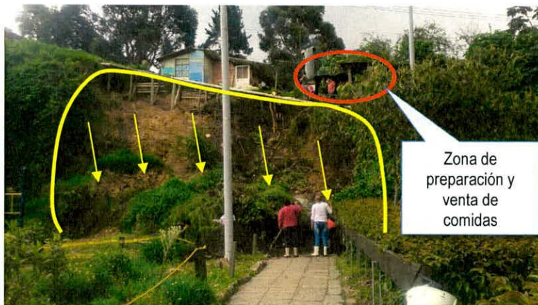
Fotografía 8. Vista del avance del proceso de remoción en masa identificado al costado norte del Parque Distrital Mirador de los Nevados. (Fotografía tomada el 15 de Mayo)
