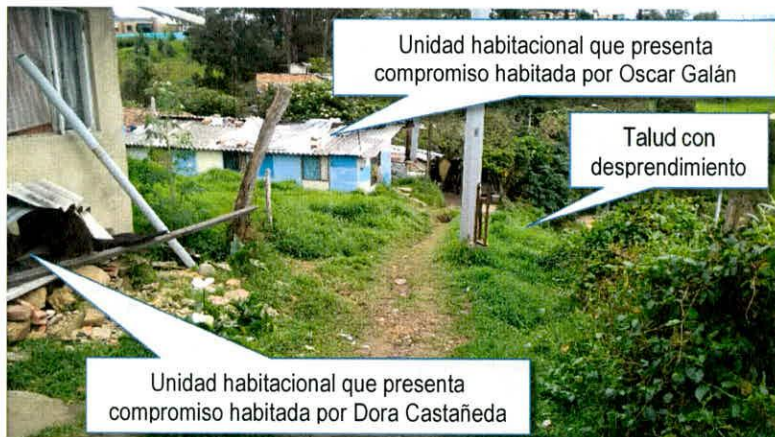
Fotografía 7. Unidades Habitacionales ubicadas en el predio de la Carrera 87 No. 145 – 50 que presentan compromiso en la estabilidad causado por la remoción en masa que se presenta en el talud. (Fotografía tomada el 19 de Abril)
