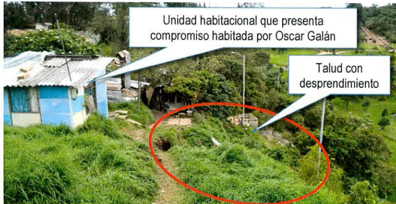
Fotografía 6. Unidad Habitacional ubicada en el predio de la Carrera 87 No. 145 – 50 que presenta compromiso en la estabilidad causado por la remoción en masa que se presenta en el talud. (Fotografía tomada el 19 de Abril)
