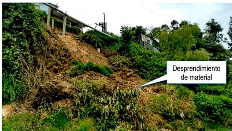
Fotografía 5. Desprendimiento del material superficial y capa vegetal del talud. (Fotografía tomada el 19 de Abril)
