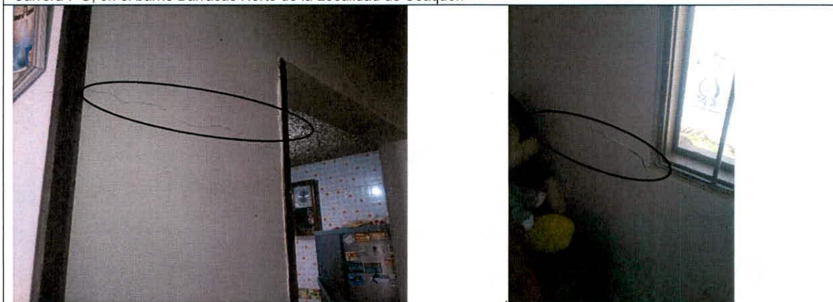
Fotografía 5,6: Vista de los daños evidenciados en las viviendas evaluadas en el sector de la Calle 159 A y Calle 160 entre Carrera 7 y Carrera 7 G, en el barrio Barracas Norte de la Localidad de Usaquén
