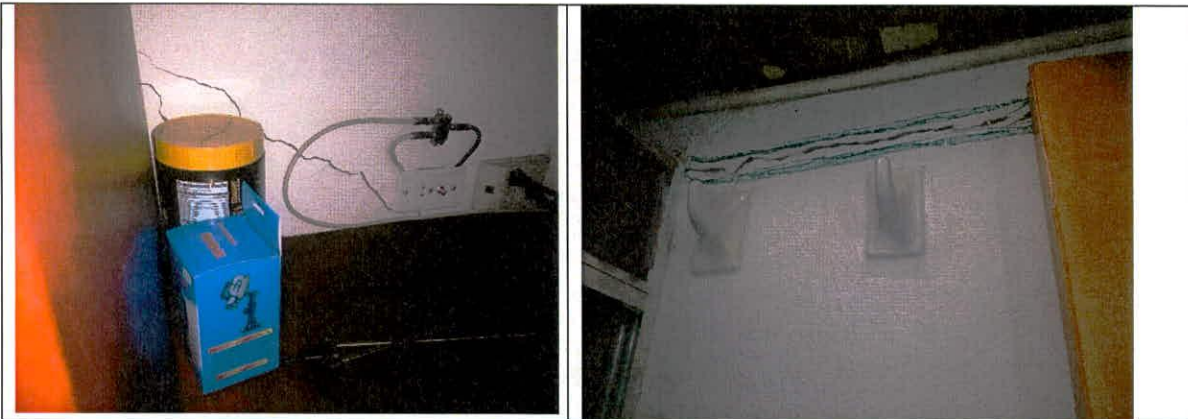
Fotografía 7,8: Vista de los daños evidenciados en las viviendas evaluadas en el sector de la Calle 159 A y Calle 160 entre Carrera 7 y Carrera 7 G, en el barrio Barracas Norte de la Localidad de Usaquén
