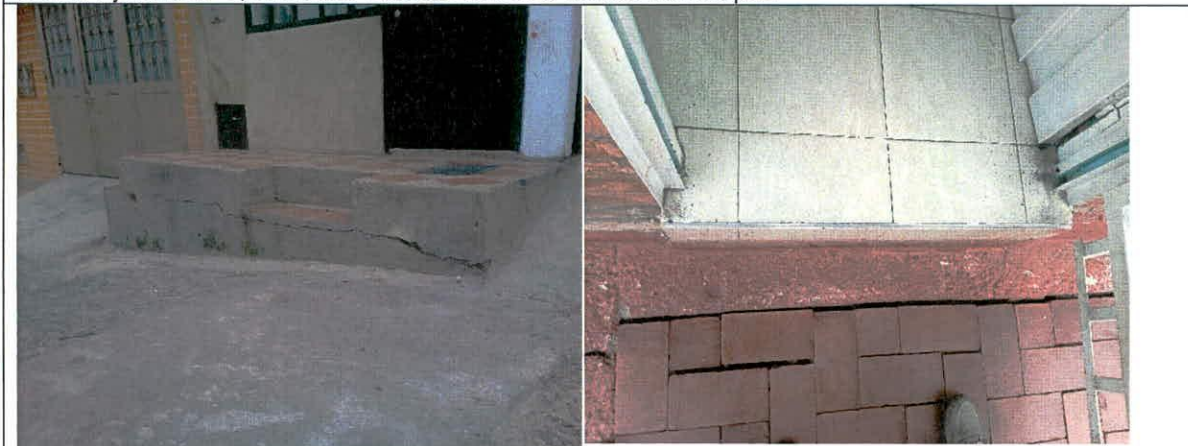
Fotografía 11,12: Vista de los daños evidenciados sobre los senderos peatonales evaluados en el sector de la Calle 159 A y Calle 160 entre Carrera 7 y Carrera 7 G, en el barrio Barracas Norte de la Localidad de Usaquén
