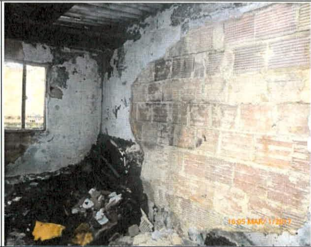
Fotografía 4. Desprendimientos de mortero.
