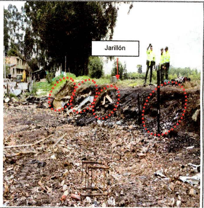
Fotografía 8. Excavaciones desarrolladas sobre el costado sur del jarillón del río Bogotá en la zona denominada Gavilanes entre la Calle 144 y el río Bogotá y entre la Carrera 151 A y la Carrera 151 G.
