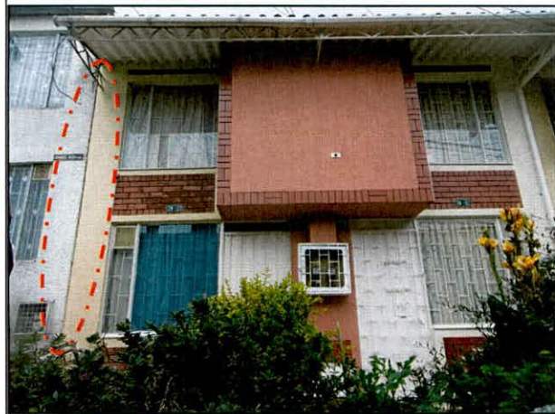
Fotografía 11. Vista de la fisura evidenciada en las juntas de separación entre las viviendas.
