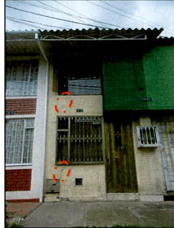
Fotografía 12. Vista de las fisuras observadas en la fachada de una de la vivienda evaluada.
