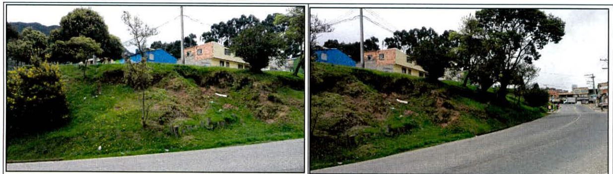
Fotografía 7 y 8. Vista del talud de corte vial localizado al costado occidental de la Urbanización Las Gaviotas, en el cual se observan escarpes de antiguos procesos los cuales al momento no presentan actividad.
