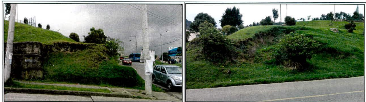
Fotografía 5 y 6. Vista del talud de corte vial localizado al costado occidental de la Urbanización Las Gaviotas, en el cual se observan escarpes de antiguos procesos los cuales al momento no presentan actividad.
