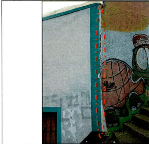
Fotografía 9. Vista de la fisura evidenciada en las juntas de separación entre las viviendas.
