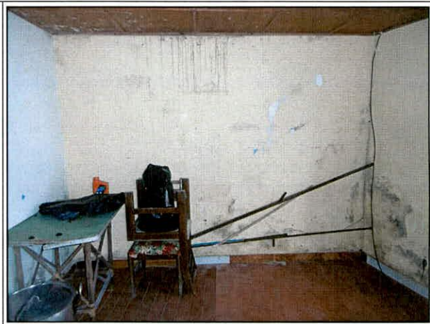
Fotografía 10. Vista de las humedades evidenciadas en una de las viviendas evaluadas.
