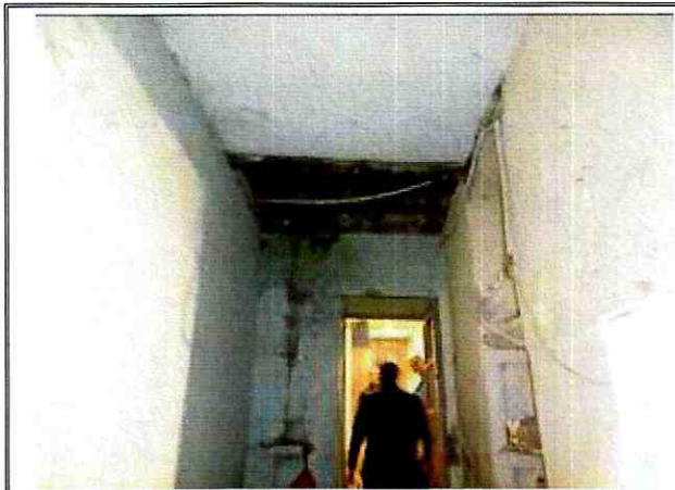
Foto No. 7 Desprendimientos recubrimiento cielo raso segundo nivel de la vivienda
