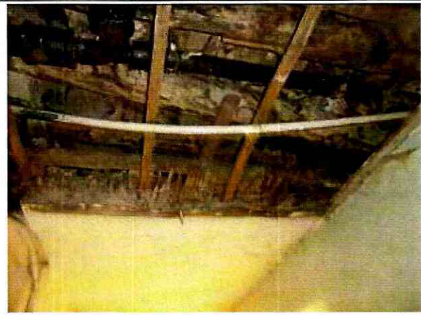
Foto No. 8. Colapso parcial cielo raso segundo nivel de la vivienda
