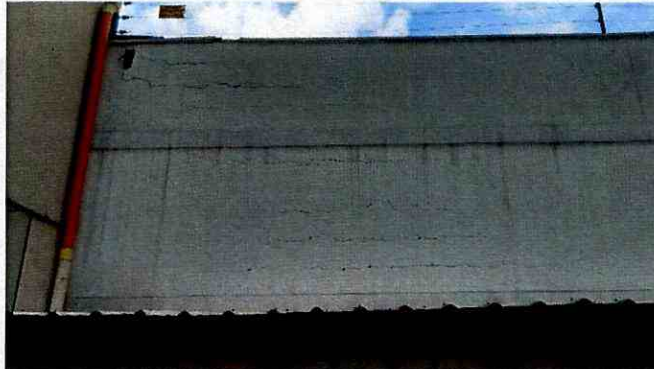
Fotografía 5. Fisuras horizontales en la parte superior del muro colindante entre los dos predios vista desde el predio de la Carrera 18 # 33A – 45.
