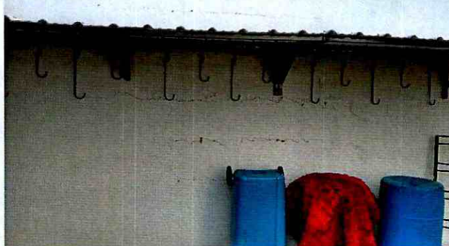
Fotografía 4. Fisuras horizontales a media altura del muro colindante entre los dos predios vista desde el predio de la Carrera 18 # 33A – 45.
