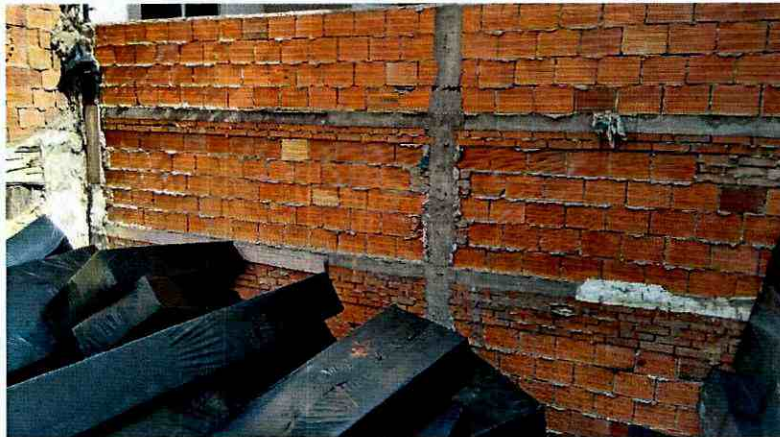
Fotografía 3. Muro de cerramiento (vista desde el predio en construcción). Se observan elementos horizontales y verticales de concreto reforzado los cuales confinan la mampostería en bloques y ladrillos.
