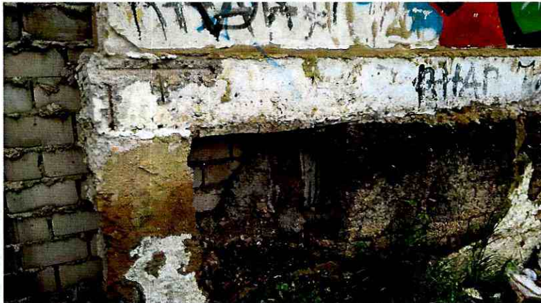
Fotografía 2. Viga intermedia que presenta pérdida del recubrimiento y óxido en el acero de refuerzo.
