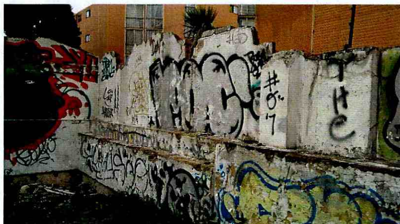
Fotografía 4. Deterioro de la mampostería en la parte superior del muro de cerramiento.
