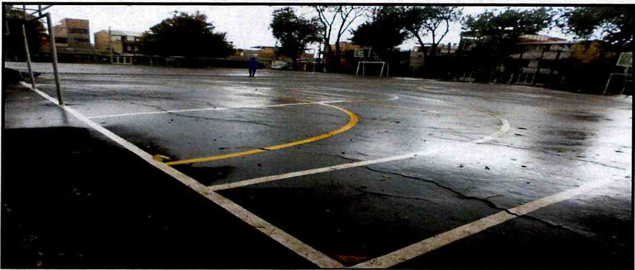
Fotografía 6. Agrietamientos en el asfalto de la cancha de fútbol del costado norte de la Sede Principal del Colegio Elisa Borrero de Pastrana,
