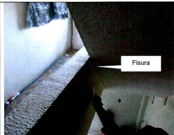
Fotografía 4. Vista en detalle de escalera entre segundo y tercer nivel de la edificación de la Av. Carrera 89 B No. 56 F -53 Sur, se observa la presencia de una fisura.
