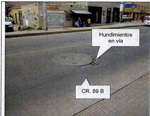
Fotografía 7. Vista general de la Carrera 89 B en sector contiguo al predio de la Av. Carrera 89 B No. 56 F -53 Sur, se observa pozo de alcantarillado con hundimiento de vía en uno de sus costados.
