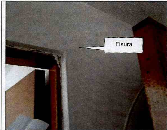
Fotografía 5. Vista en detalle de muro de segundo nivel de la edificación de la Av. Carrera 89 B No. 56 F -53 Sur, se observa la presencia de una fisura.
