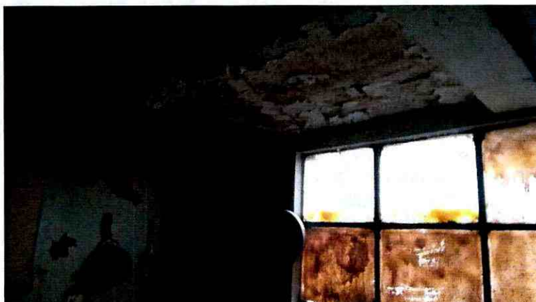
Fotografía 2. Presencia de humedad en la placa de techo del segundo piso, en la parte posterior del inmueble
