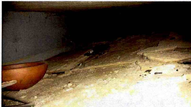
Fotografía 5. Se observa desprendimiento del pañete que sirve como acabado de la placa de techo del segundo piso en el apartamento ubicado en el costado oriental.
