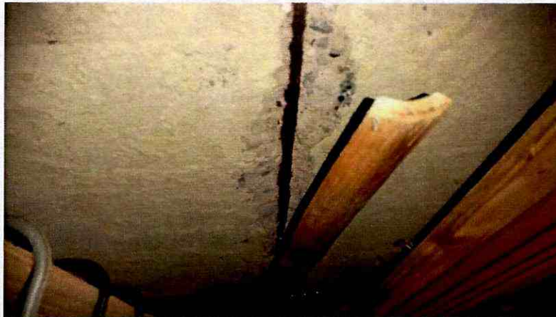
Fotografía 4. El acero de refuerzo de la placa del techo del segundo piso en el apartamento ubicado en el costado oriental del inmueble. Se evidencia presencia de corrosión en el acero de refuerzo de la placa.
