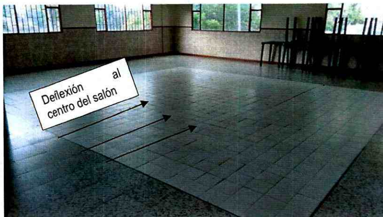
Fotografía 8. Placa del segundo piso del bloque sur con una leve deflexión, sin embargo no se presentan daños en los acabados.
