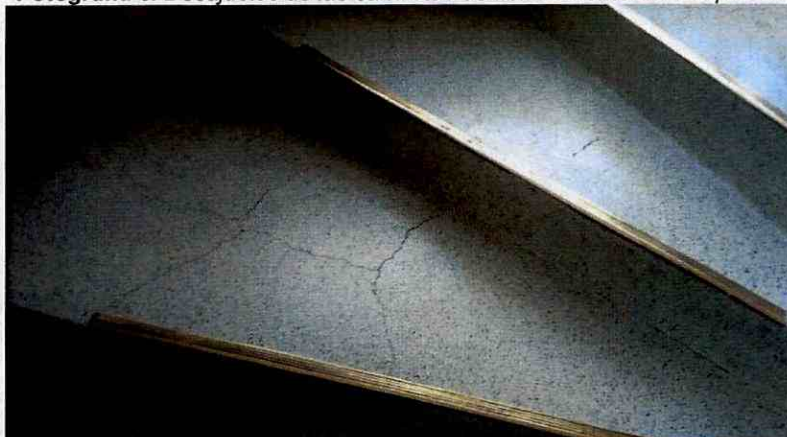
Fotografía 7. Fisuras irregulares en el acabado de las escaleras de acceso al segundo nivel del bloque sur
