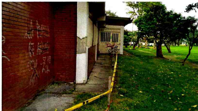
Fotografía 4. Pérdida del pañete de la columna ubicada en la fachada del costado oriental del bloque sur
