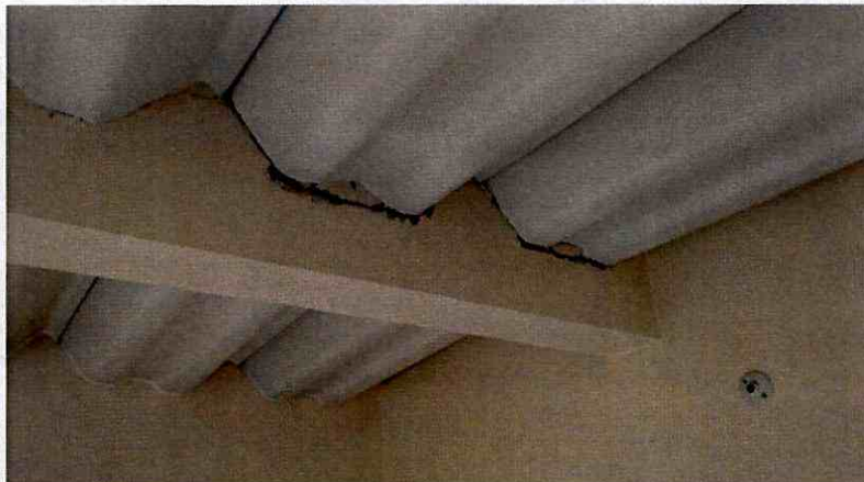
Fotografía 6. Desajustes de las canaletas de fibrocemento del bloque sur
