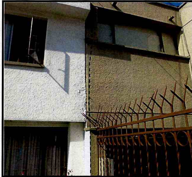
Fotografías 3. Junta entre las fachadas principales de los predios de la Calle 106 No 49-05 y Calle 105 No 49-02/08.
