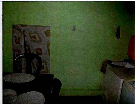
Fotografía 4. Vista en detalle de muro interior posterior (costado oriental) de la edificación de la Carrera 87 C No. 128 A – 04, no se observan daños estructurales importantes.
