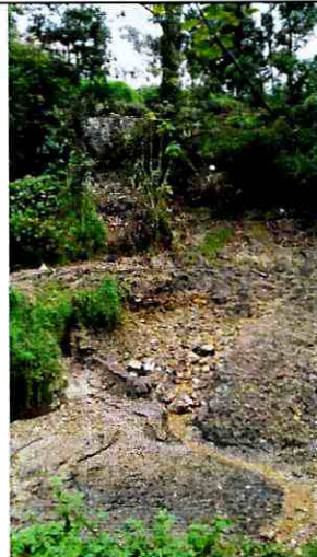
Fotografía 13. Vista del cuerpo de deslizamiento desde la parte baja del deslizamiento. Se encuentra saturado el material. Fotografía tomada el 16 de Abril.
