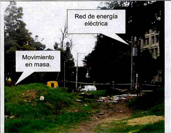
Fotografía 2. Vista de zona por encima del escarpe superior del movimiento (costado norte), se identifica red eléctrica aérea. Fotografía tomada el 11 de Abril.
