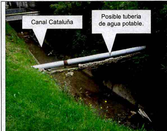
Fotografía 1. Vista de sector de Canal Cataluña por encima del escarpe superior del movimiento, se identifica posible tubería de agua potable de 6". Fotografía tomada el 11 de Abril.
