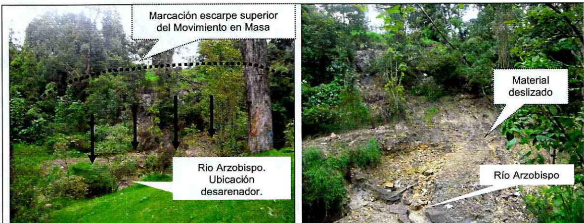
Fotografía 6 Vista panorámica desde la parte baja del movimiento en masa. Se observa material deslizado y pérdida de verticalidad de individuos arbóreos. Fotografía tomada el 11 de Abril.
