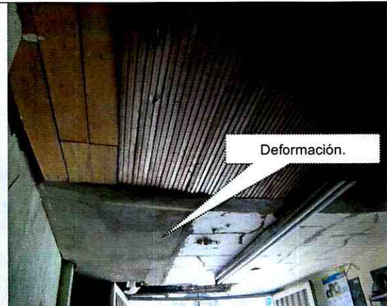
Fotografía 4. Vista del cielo raso del local ubicado en el costado noroccidental del predio, se observan daños (deformaciones y grietas).
