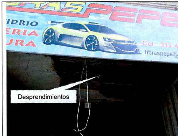
Fotografía 3. Vista de cielo raso, con daños en cielo rasos (desprendimientos y deformaciones).
