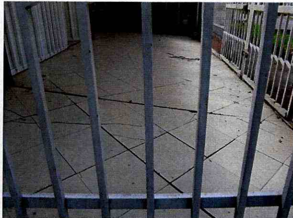
Foto 6. Vista de piso costado norte (parqueadero, se observa deformación y grietas. 05 Septiembre de 2016.
