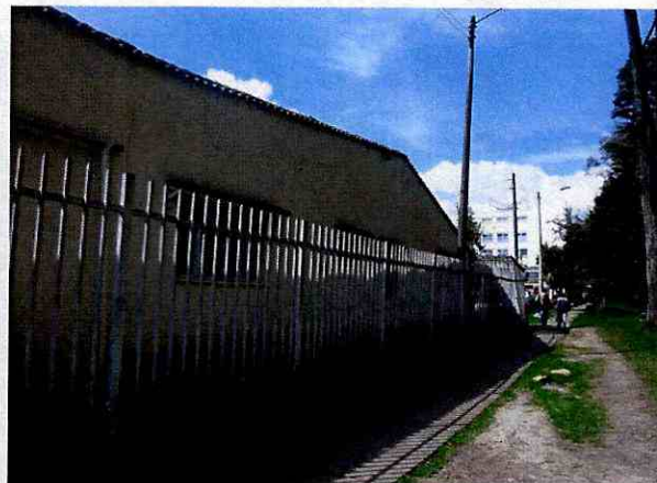
Foto 6. Vista del costado oriental del predio, se observan presencia de grietas en muros y andén. 05 Septiembre de 2016.
