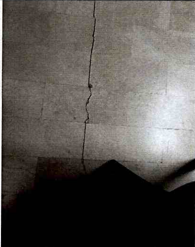
Foto 5. Vista de piso con presencia de fisura en zona de sala. DI-9147 – 19 Septiembre de 2016.
