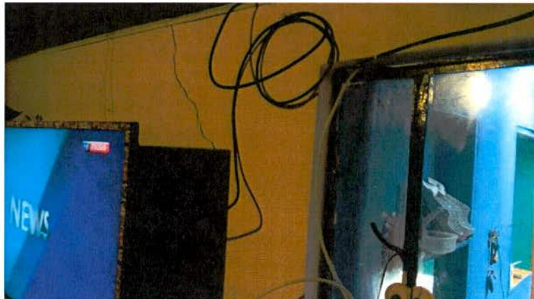
Fotografía 3. Fisuras en muros interiores del predio de la Calle 185 A # 9 – 12.
