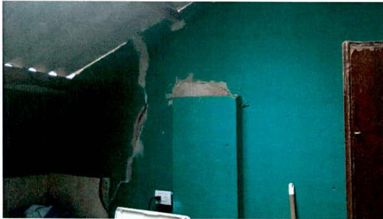
Fotografía 4. Fisuras con tendencia vertical en muro del costado norte del predio Calle 185 A # 9 – 12.
