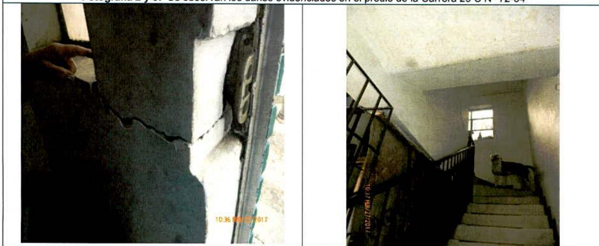
Fotografía 2 y 3: Se observan los daños evidenciados en el predio de la Carrera 29 C N° 72-70
