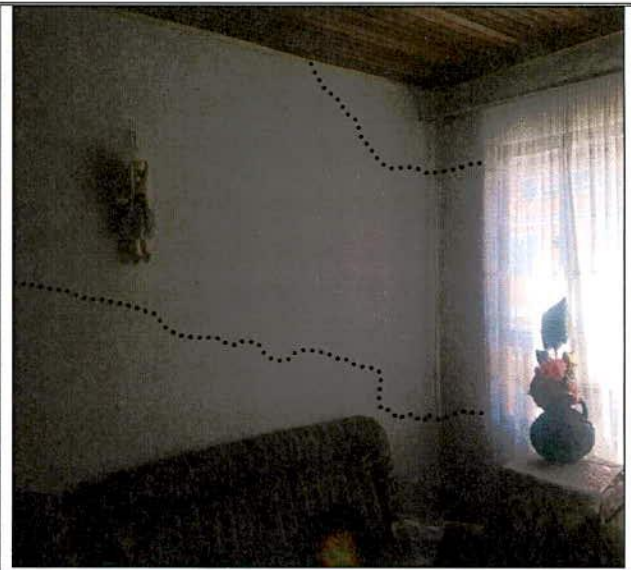
Fotografía 8. Grietas y fisuras identificadas en muros de cerramiento y divisorios de la vivienda ubicada en el predio de la Calle 187 A No. 8 A – 06, en el Sector Catastral Tibabita de la Localidad Usaquén.
