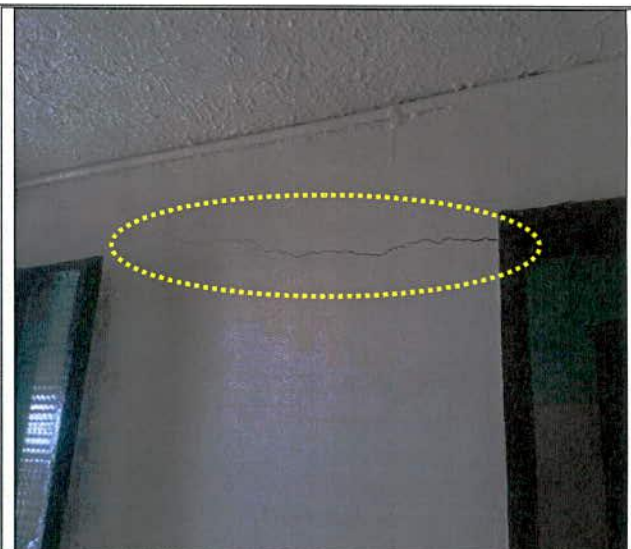
Fotografía 4. Grietas y fisuras identificadas en muros de cerramiento y divisorios de la vivienda ubicada en el predio de la Calle 187 A No. 8 A – 06, en el Sector Catastral Tibabita de la Localidad Usaquén.
