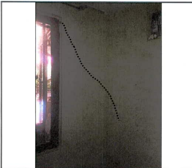
Fotografía 5. Grietas y fisuras identificadas en muros de cerramiento y divisorios de la vivienda ubicada en el predio de la Calle 187 A No. 8 A – 06, en el Sector Catastral Tibabita de la Localidad Usaquén.
