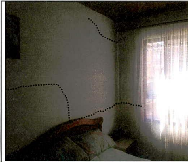
Fotografía 7. Grietas y fisuras identificadas en muros de cerramiento y divisorios de la vivienda ubicada en el predio de la Calle 187 A No. 8 A – 06, en el Sector Catastral Tibabita de la Localidad Usaquén.
