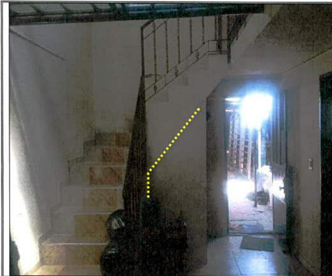
Fotografía 3. Grietas y fisuras identificadas en muros de cerramiento y divisorios de la vivienda ubicada en el predio de la Calle 187 A No. 8 A – 06, en el Sector Catastral Tibabita de la Localidad Usaquén.
