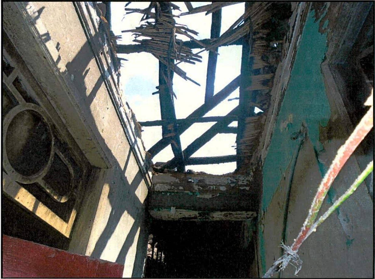
Fotografía 2. Colapso parcial de la cubierta del costado posterior del predio de la Carrera 13 No 20-72/74.
