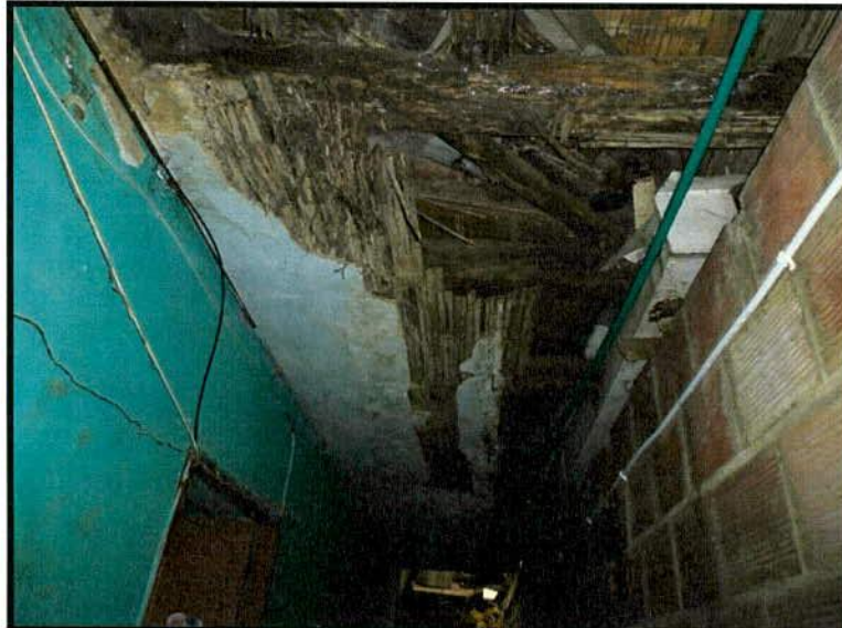
Fotografía 2. Desprendimientos del cielorraso del hall que conduce a las alcobas de la vivienda evaluada.
