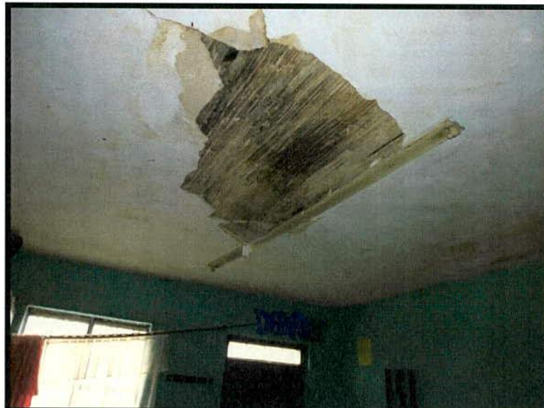
Fotografía 3. Desprendimiento del mortero del cielorraso en la alcoba principal de la vivienda evaluada
