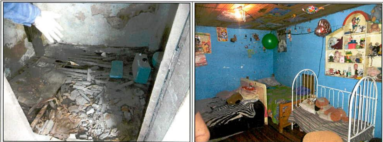
Foto 5. Vista de los daños del contrapiso en madera de la habitación que se encuentra deshabitada.
