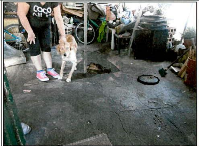
Foto 8. Vista del hundimiento de la placa de entpiso del tercer nivel, la cual presenta un hundimiento en su parte central.
