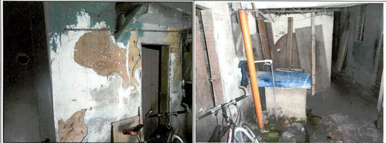
Foto 3 y 4. Vista del deterioro de la vivienda evaluada, relacionado con la falta de mantenimiento de la misma.
