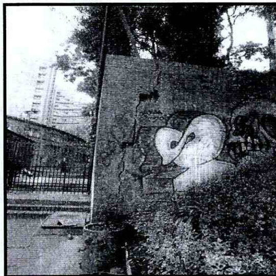
Fotografía 8. Situación del muro de cerramiento de una de las zonas verdes del conjunto residencial Torres del Parque junto a la entrada Numero 1 de La Plaza de Toros evidenciada en Enero de 2017
