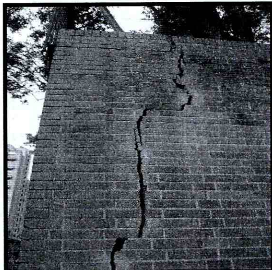
Fotografía 6. Situación del muro de cerramiento de una de las zonas verdes del conjunto residencial Torres del Parque junto a la entrada Numero 1 de La Plaza de Toros evidenciada en enero de 2011.
