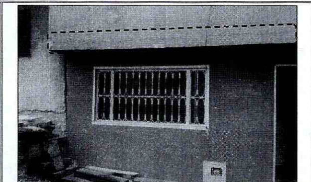
Foto No. 8. Fisuras de tendencia horizontal evidenciada en el predio de la Carrera 5F Este No. 88-03 Sur (RO-71950 – Junio de 2014)
