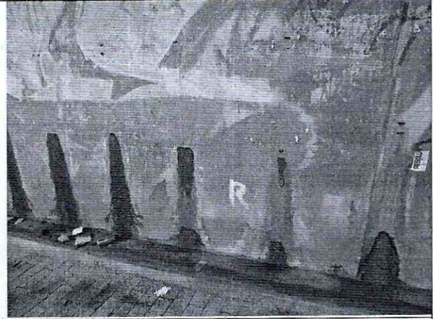
Fotografía 4: Vista del rastro del agua con oxido sobre las paredes del muro
