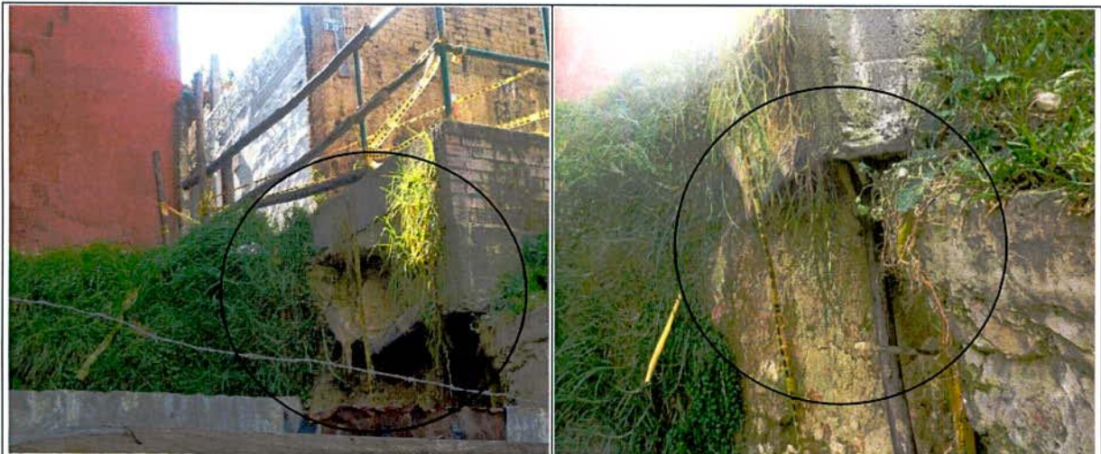
Fotografías 3-4.Desprendimientos de piedra rajón, las cuales se depositan al interior del predio de la Carrera 3 Este No 9-38 (predio vacío).
