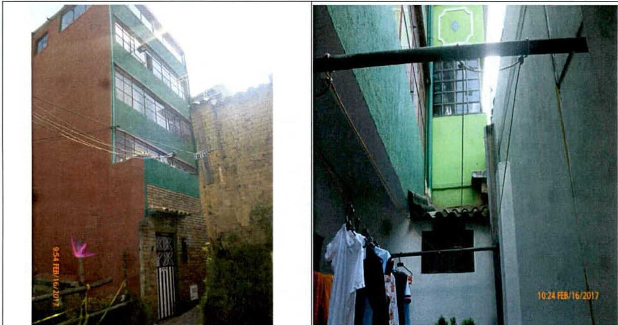
Fotografías 5 y 6. Predio de la Carrera 3 Este No 9-36, localizado en la parte alta del talud evaluado.
