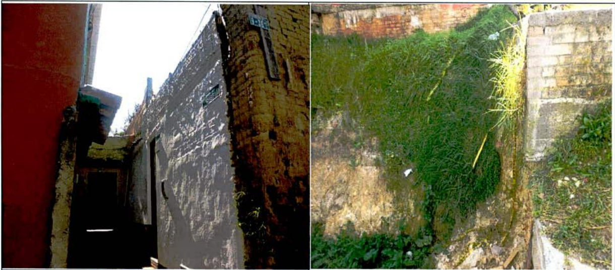
Fotografías 1 y 2 Sector evaluado Carrera 3 Este con Calle 9 , en el barrio Los Egipto de la Localidad de Candelaria
