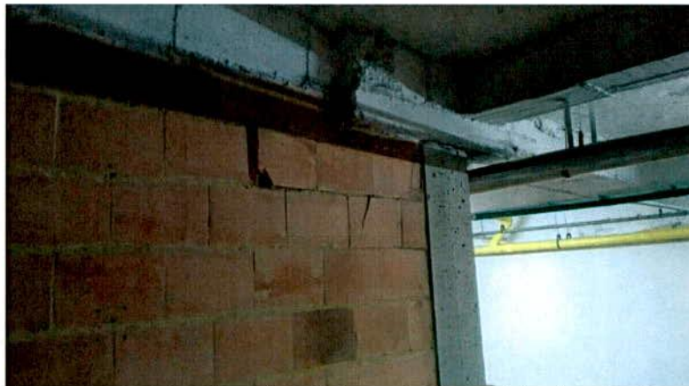
Fotografía 6. Daño en mampostería reforzada que sirve como apoyo de la placa de sótano de plataforma de parqueaderos.
