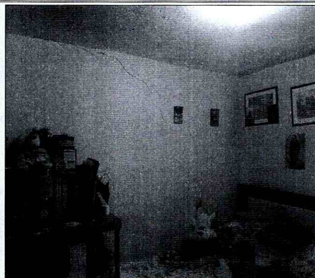
Fotografía 6. Grietas identificadas en muros de la vivienda emplazada en el predio de la Carrera 81 No. 75 – 19, en el Sector Catastral La Soledad Norte de la Localidad de Engativá.
