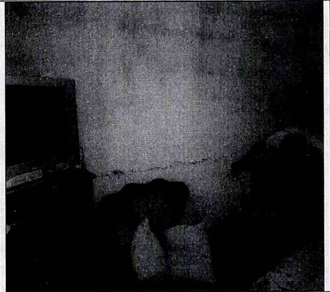
Fotografía 10. Grietas identificadas en muros de la vivienda emplazada en el predio de la Carrera 81 No. 75 – 35, en el Sector Catastral La Soledad Norte de la Localidad de Engativá.
