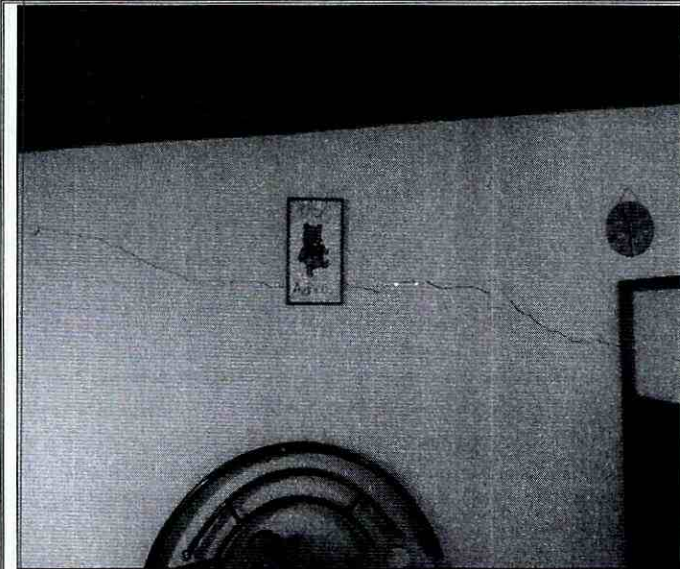
Fotografía 13. Grietas identificadas en muros de la vivienda emplazada en el predio de la Carrera 81 No. 75 – 35, en el Sector Catastral La Soledad Norte de la Localidad de Engativá.
