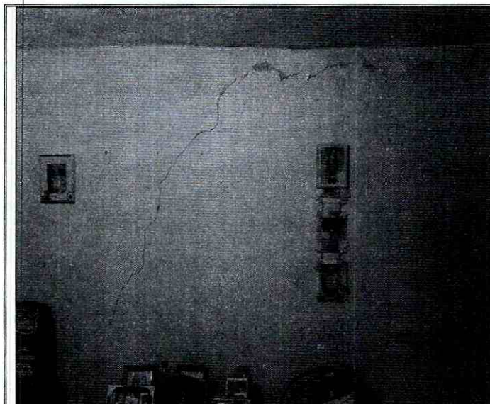
Fotografía 5. Grietas identificadas en muros de la vivienda emplazada en el predio de la Carrera 81 No. 75 – 19, en el Sector Catastral La Soledad Norte de la Localidad de Engativá.
