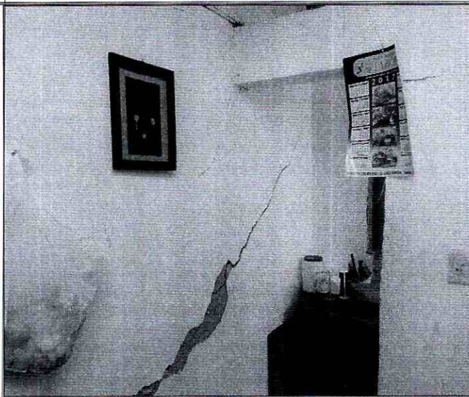
Fotografía 23. Grietas identificadas en muros de la ampliación de la zona posterior de la vivienda emplazada en el predio de la Carrera 81 No. 75 - 49, en el Sector Catastral La Soledad Norte de la Localidad de Engativá, en donde se ubica la cocina y el patio de un apartamento.
