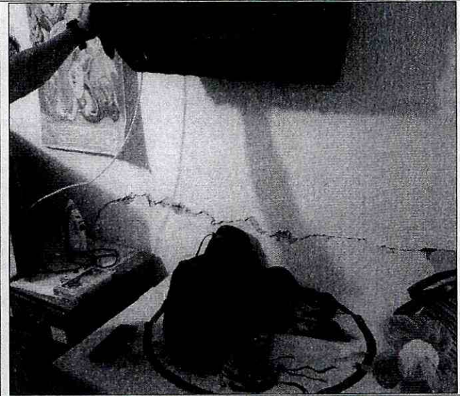
Fotografía 12. Grietas identificadas en muros de la vivienda emplazada en el predio de la Carrera 81 No. 75 – 35, en el Sector Catastral La Soledad Norte de la Localidad de Engativá.
