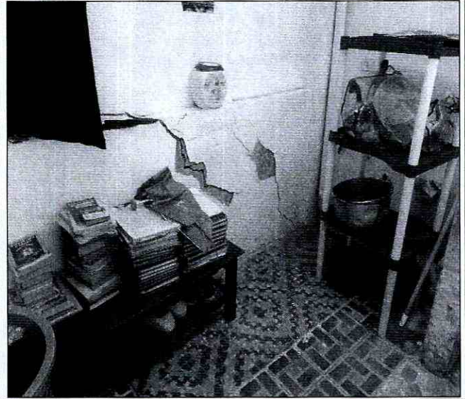
Fotografía 22. Grietas identificadas en muros de la ampliación de la zona posterior de la vivienda emplazada en el predio de la Carrera 81 No. 75 - 49, en el Sector Catastral La Soledad Norte de la Localidad de Engativá, en donde se ubica la cocina y el patio de un apartamento.
