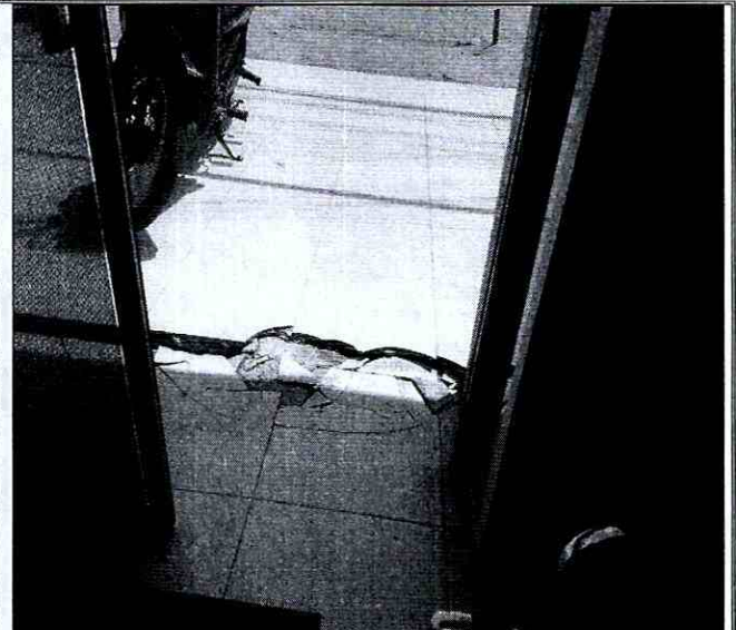
Fotografía 16. Hundimiento identificado en la zona de acceso a la vivienda emplazada en el predio de la Carrera 81 No. 75 – 35, en el Sector Catastral La Soledad Norte de la Localidad de Engativá.
