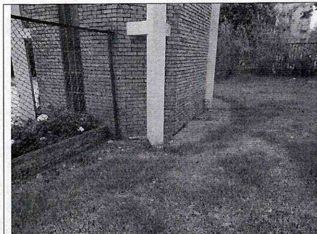
Fotografía 7: Afectaciones en la superficie observadas junto a la torre
