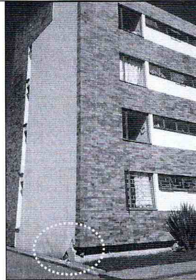
Fotografía 2. Costado sur de la edificación del predio de la Calle 147 No. 11 – 27, en el Sector catastral Caobos Salazar de la Localidad Usaquén, en donde se observan fracturas en el muro de cerramiento del sótano.
