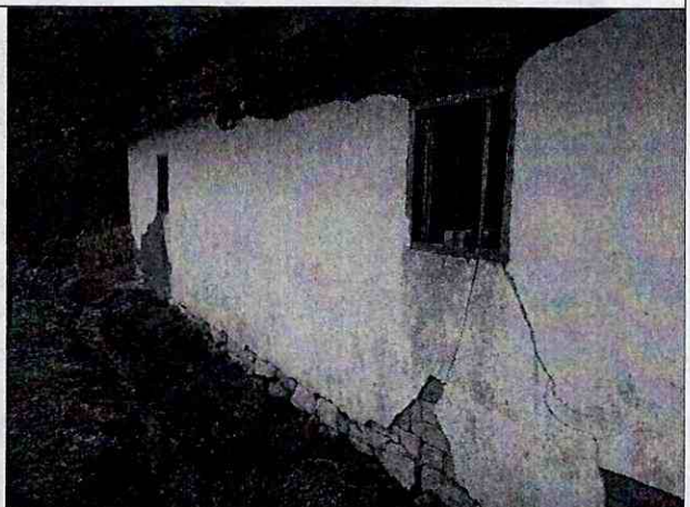
Fotografía 14. Afectaciones al exterior de la vivienda – Se observan sobre el mortero de recubrimiento
