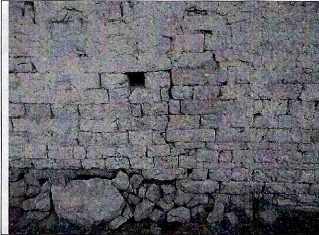
Fotografía 19. Afectaciones observadas al exterior de la vivienda de la Sr. Rubén Vásquez
