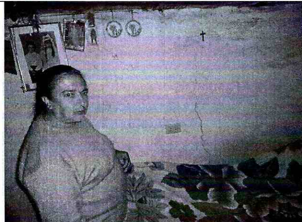
Fotografía 8. Afectaciones indicadas por quienes acompañan la visita
