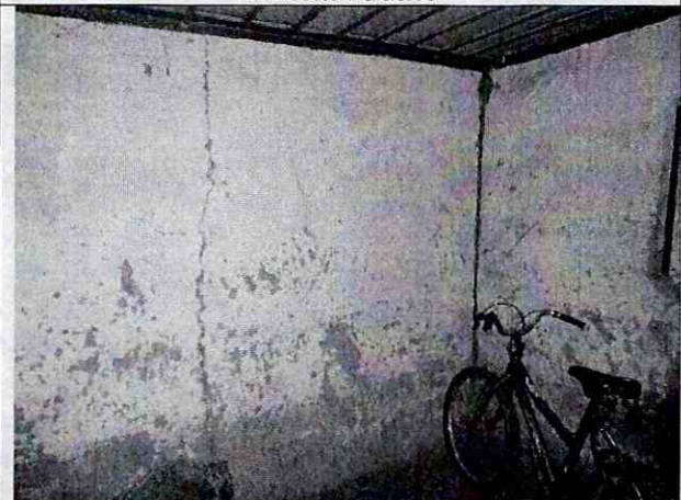
Fotografía 13. Afectaciones al interior de la vivienda – Se observan sobre el mortero de recubrimiento
