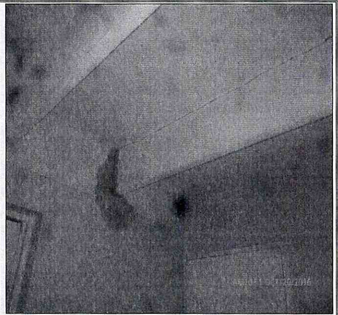
Fotografía 6. Grietas identificadas en placa de entepiso de la vivienda ubicada en la parte posterior del predio de la Av. Cra. 19 No. 150 – 81, en el Sector Catastral Las Margaritas de la Localidad Usaquén.
