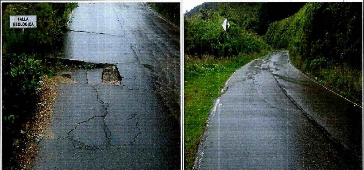
Fotografía 3 y 4 .Desprendimientos de la capa de rodadura el algunos sectores y hundimientos.
