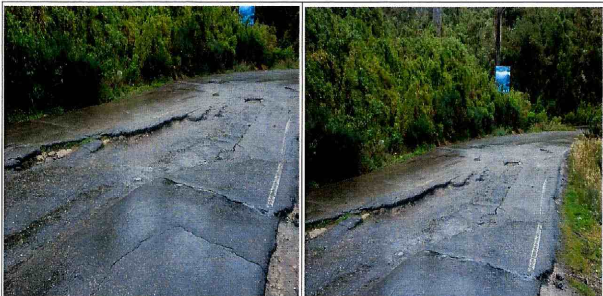
Fotografía 1. Daños en la estructura del pavimento.
