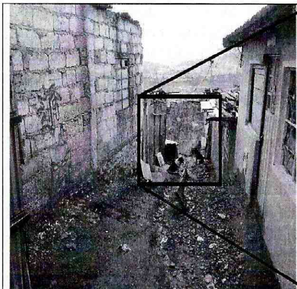
Fotografía 4. Vista general del sector evaluado (ladera arriba) en el recuadro se muestra el sector donde se presenta el movimiento en masa.
