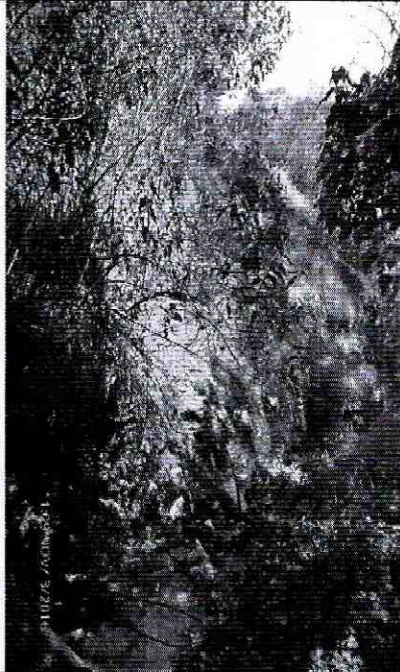
Foto 8. Vista del desprendimiento de material de cobertura vegetal del talud ubicado al costado sur de la Quebrada Puente Piedra.
