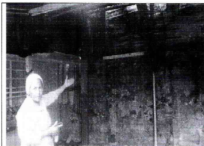
Fotografía 3. Vista al interior de la vivienda por donde ingresan aguas de escorrentía.
