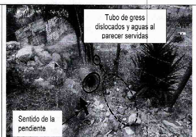
Fotografía 6. Tubos de gres dislocados y aguas al parecer servidas discurriendo ladera abajo.
