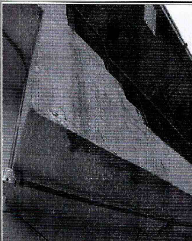
Foto No. 6. Humedades en muros divisorios y de cerramiento perimetral edificación Sede A Sección Primaria
