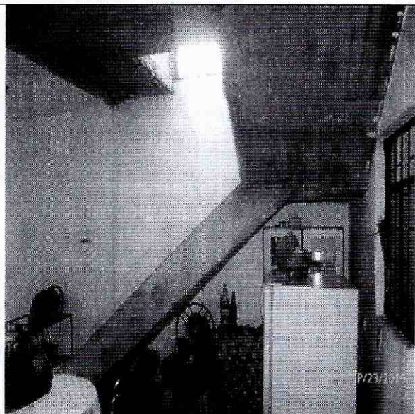
Fotografía 2. Vista de espacio interior de primer nivel (costado oriental) de la edificación evaluada, se observa un buen estado de conservación.
