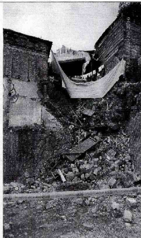
Fotografías 2 y 3 – Desprendimiento de material causado presuntamente por el corte realizado recientemente en la ladera.
