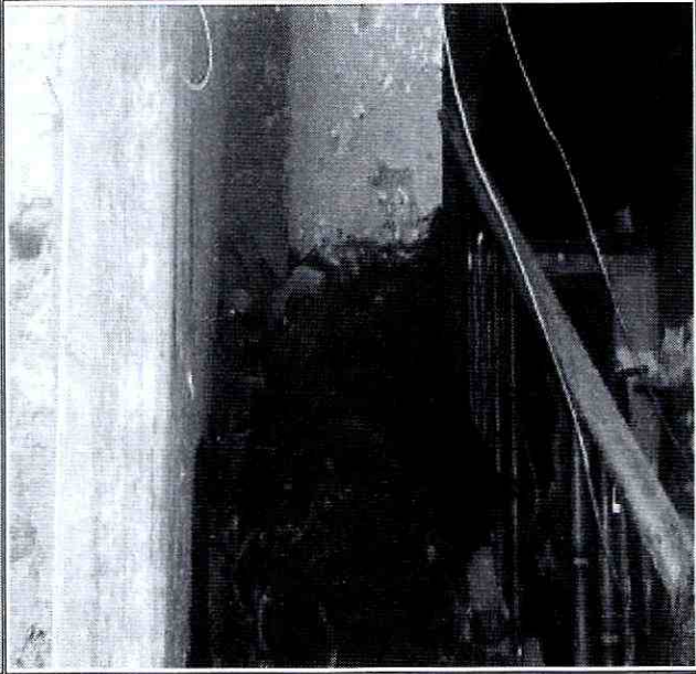
Foto No. 6. Afectaciones en el sector de la escalera de la vivienda emplazada en el predio de la Calle 6 B No. 3 A - 36
