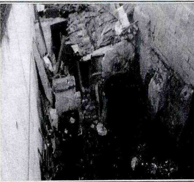
Foto No. 4. Elementos incinerados en el sector del patio de la vivienda emplazada en el predio de la Calle 6 B No. 3 A - 36
