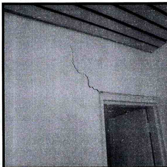
Fotografías 4. Grieta de tendencia diagonal en los muros divisorios del Salón Comunal
