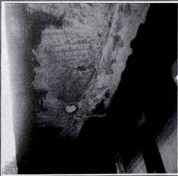
Foto No. 3. Humedades y desprendimientos de material de recubrimiento de la estructura
