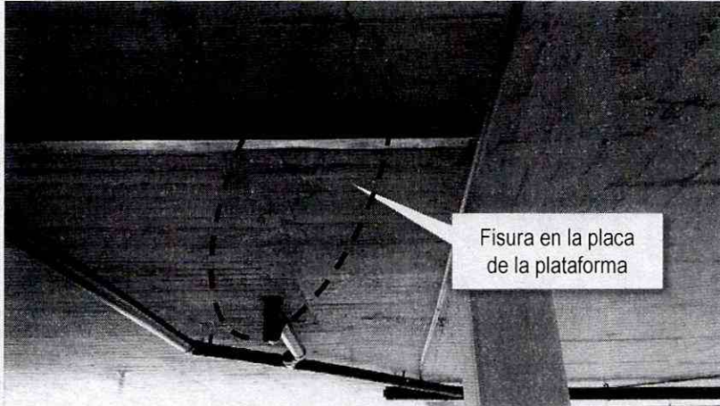
Fotografía 2. Fisura en plataforma perimetral a nivel de sótano donde se apoya en el edificio principal.
